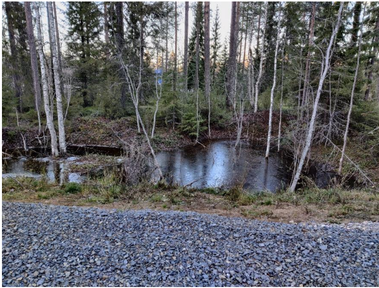
Kuva 6. Kuoppa latupohjan/ulkoilureitin alittavan rummun itäpuolella, jossa vesi seisoo nykyisin.
