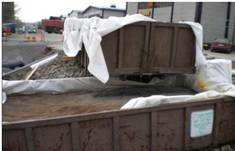
Kuva 31. Vaihtolavalla toteutettu hulevesien suodatus.
