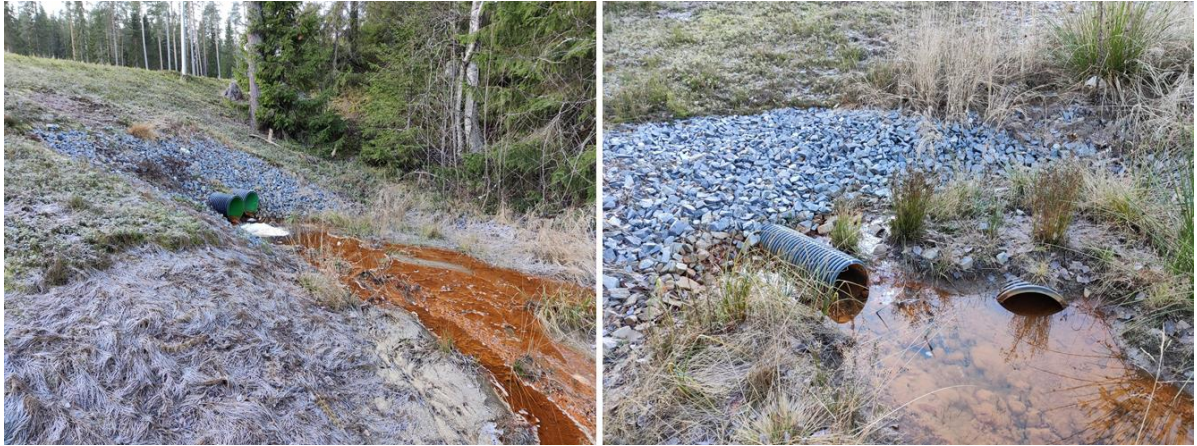
Kuva 8. Hulevesien purku viivytysaltaaseen (vasen) ja altaan itäpuolen purkuojaan (oikea).
