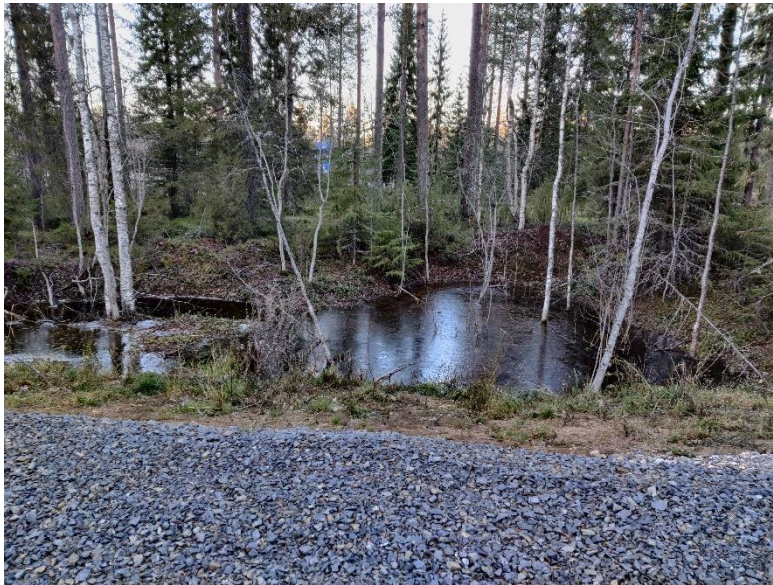
Kuva 6. Kuoppa latupohjan/ulkoilureitin alittavan rummun itäpuolella, jossa vesi seisoo nykyisin.
