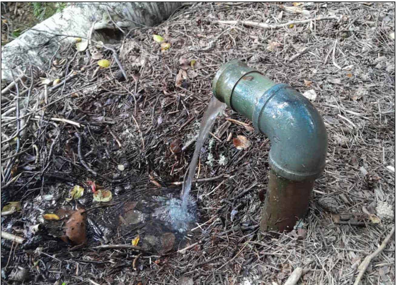
Kuva 5. Jäätiönlammissa sijaitseva ylivuotoputki, josta purkautuu pohjavettä.
